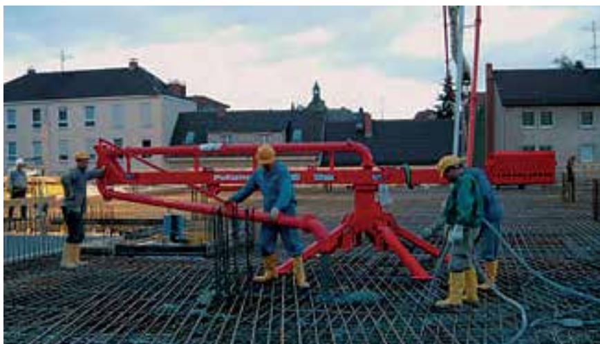
DISTRIBUIDORES DE CONCRETO RV 0, RV 7, RV 10, RV 12 Y RV 13
