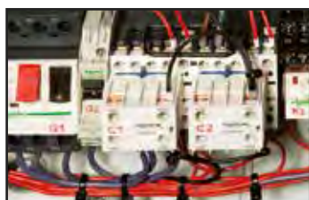
Protector magnetotérmico mediante disyuntores.
